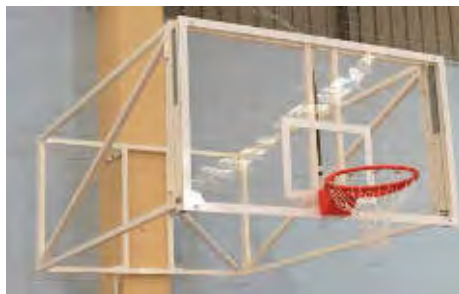
Canasta de 2,5 m de vuelo sujeta a columna mediante soporte metálico y cable tirante.
